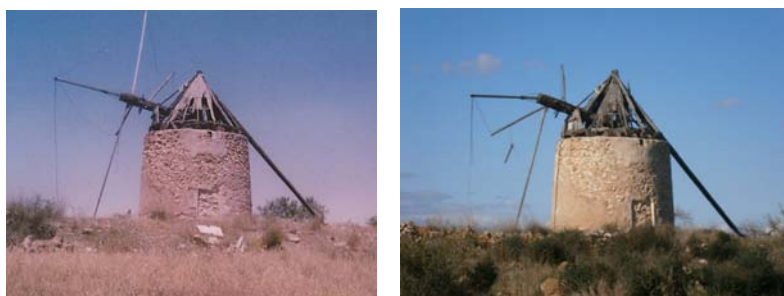
Figuras 14 y 15. Vistas del molino de los Mayordomos en Las Palas en 1998 (izquierda) y 2012 (derecha), donde se aprecia el progresivo deterioro en los palos y el botalón
