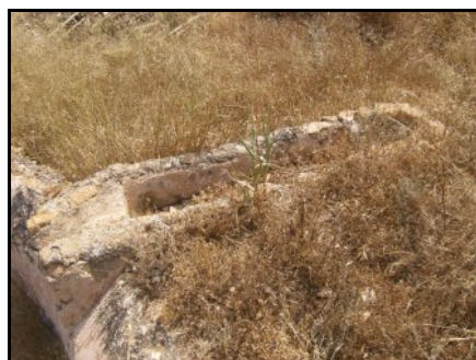
Figura 6: Detalle de tramo de canal sobre el andén con la salida del sifón en un extremo y el chorreor de la balsa en el otro. A la dcha. del sifón se encuentra la zona de paso de la caballería. Noria de Los Gálvez del Marañal en Fuente Álamo de Murcia
